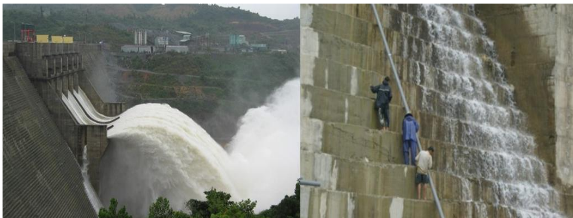
Hình 29: Hiện tượng nút, rò rỉ nước tại bờ đập Sông Tranh 2 gây nhiều lo lắng cho chính quyền địa phương cũng như nhân dân vùng hạ lưu công trình.
