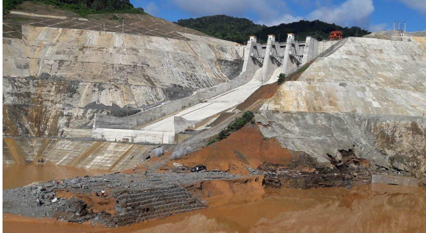
Hình 2 Vỡ thủy điện Sông Bung 2.
