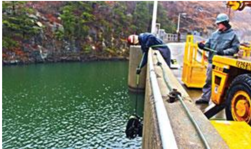
Hình 24: Phương tiện hoạt động từ xa này đang được hạ xuống nước để thực hiện kiểm tra hệ thống công.
