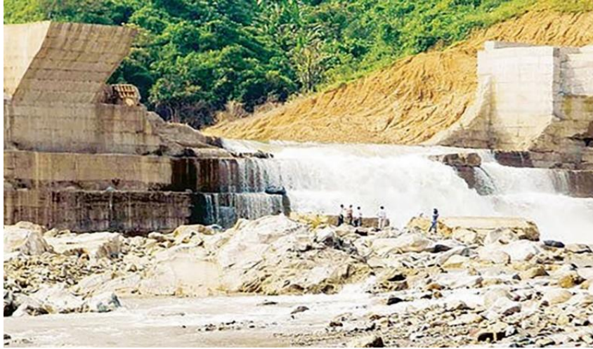
Hình 1: Thủy điện Đa Krông 3 (Quảng Trị) xảy ra sự cố vỡ thân đập trước khi phát điện khiến người dân âu lo.
