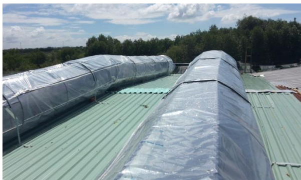
Hình 3: Ống thu năng lượng mặt trời được lắp trên mái nhà cung cấp nhiệt cho quá trình sấy
