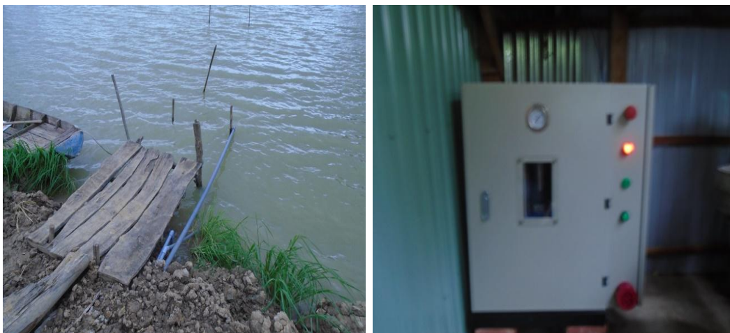
Hình 13: Hệ thống được lắp đặt tại An Giang
