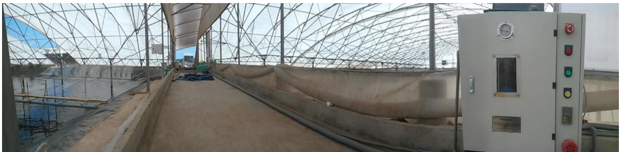
Hình 12: Hệ thống được lắp đặt tại Bạc Liêu.
