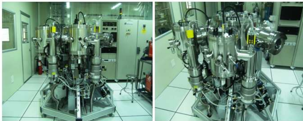
Hình 10: Hệ thống PECVD Cluster lắp đặt tại LNT
